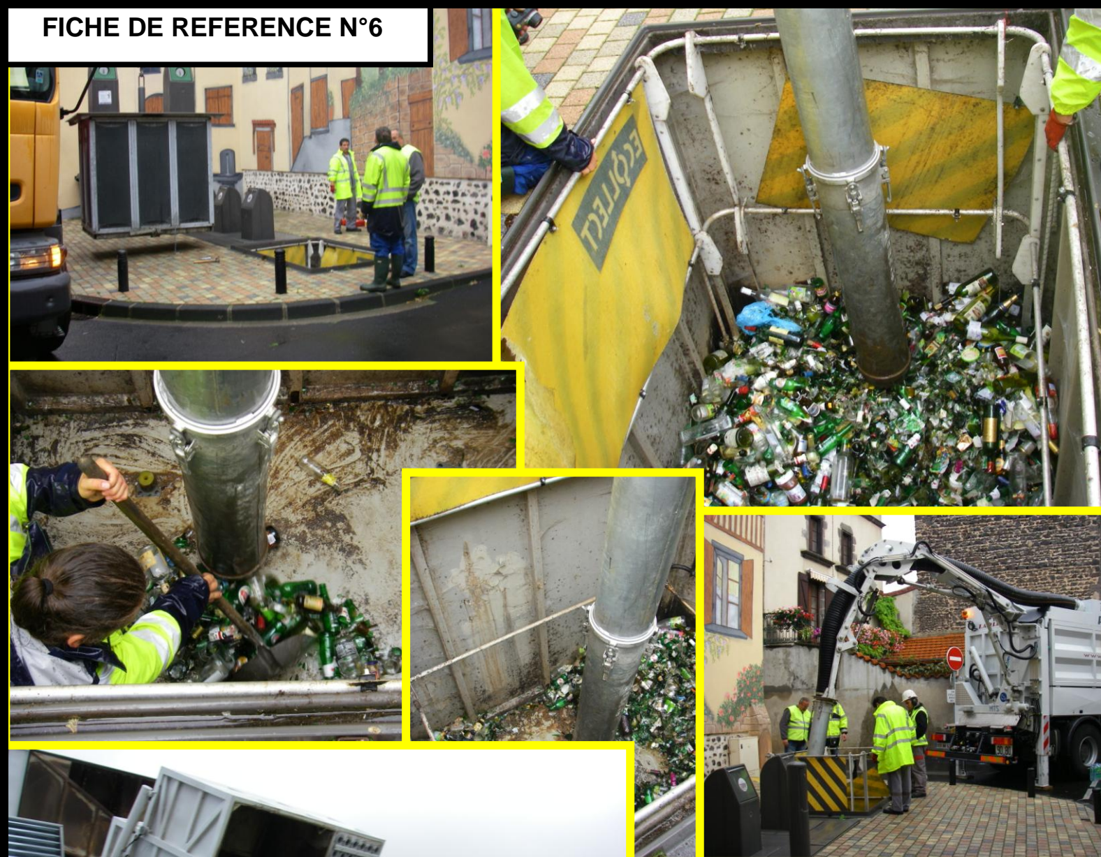
Aspiration de verre dans la fosse d'un container de recyclage BEAUMONT (63)
